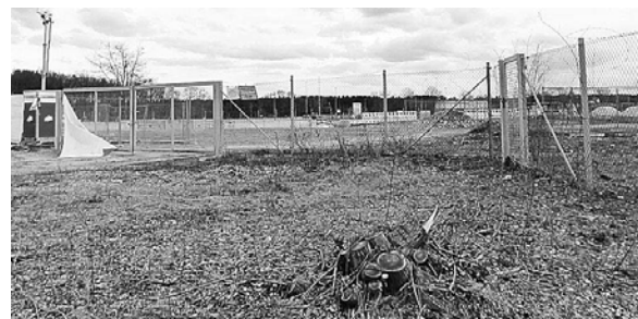
Der Bau der Entladeanlage für fremde Salzwässer am Schacht in Wathlingen ruht nach Klageerhebung durch die BI Umwelt
