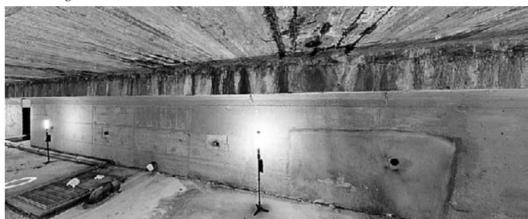
Kellerdecke mit Betonabplatzungen und korrodiertem Bewehrungsstahl im Bereich der Überlaufrinne.
