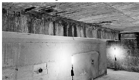
Kellerdecke mit Betonabplatzungen und korrodiertem Bewehrungsstahl unter den Duschen.
