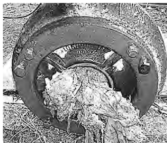
Feuchttücher verstopfen diese Abwasserpumpe
