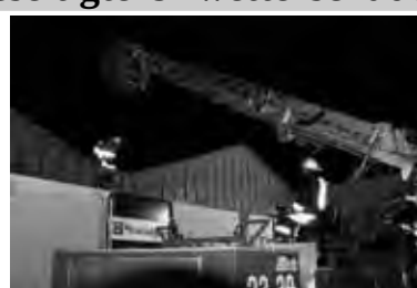
Mit Hilfe der Drehleiter stieg ein Feuerwehrmann auf das Gebäudedach und machte die Regenabläufe wieder frei.
